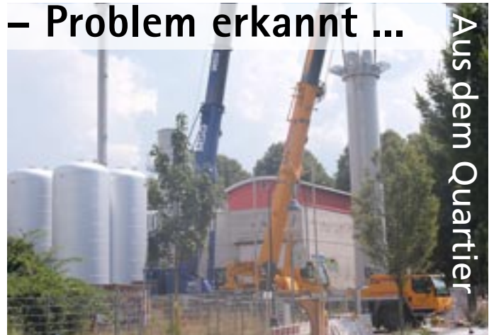
Heizwerk mit den vier großen Wärmepumpen.
